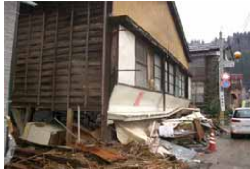
この通り沿いの家々はほとんど倒壊してしまっていた(川口町)
